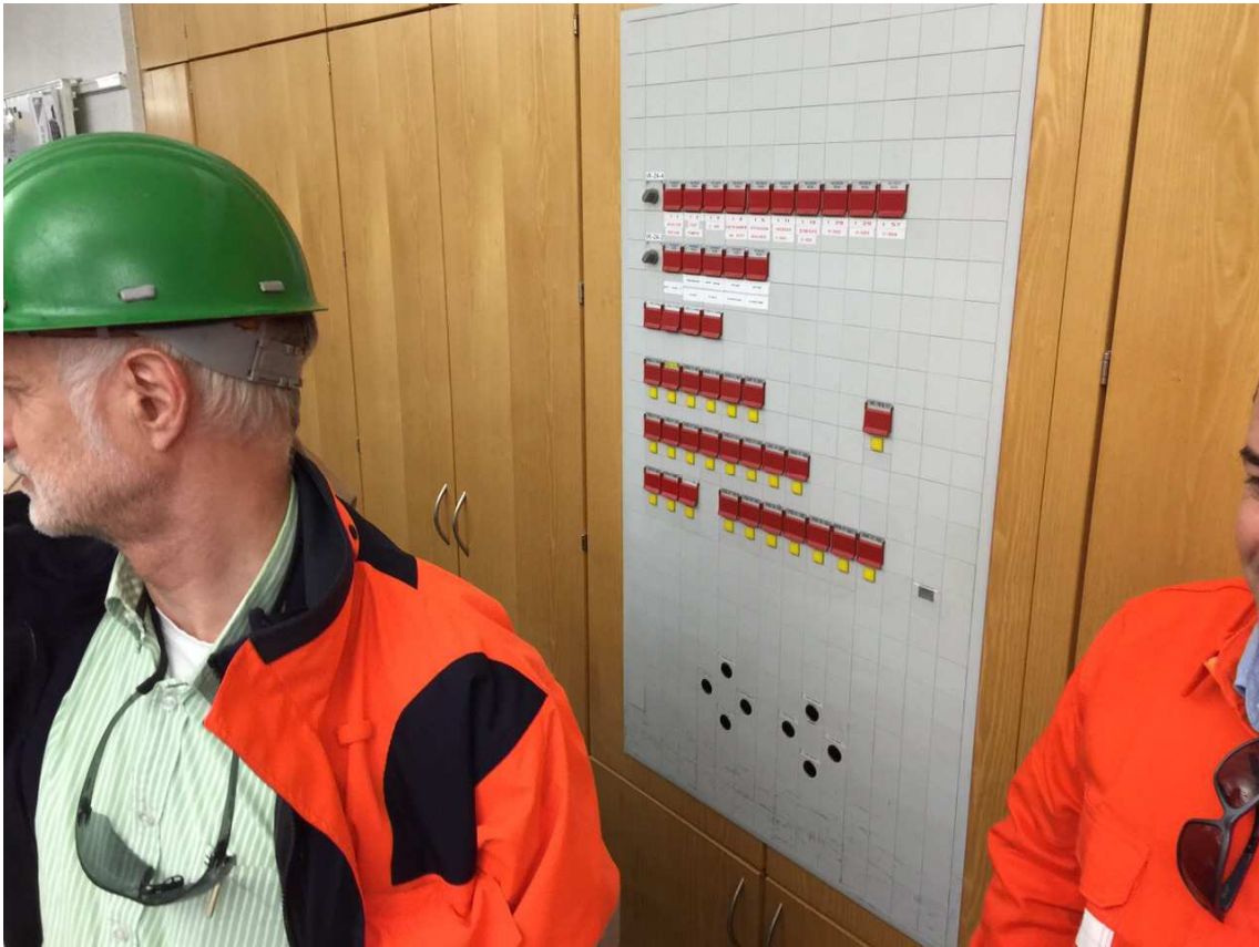
Figura 7. Painel de botoeiras de trip localizado na parede atrás dos monitores de SDCD.
